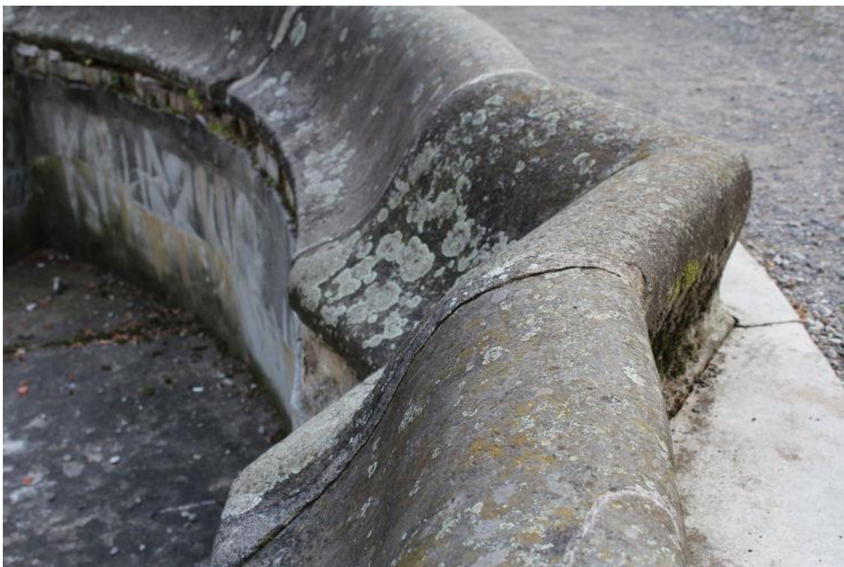
3. Stan zachowania zwieńczenia zbiornika wykonanego z bloków piaskowca.
